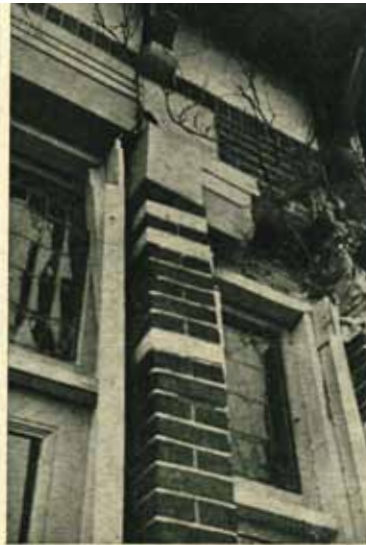
Een granaatscherf trof de voorgevel.
